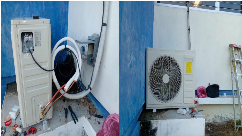
Imagen 24. Mantenimiento preventivo de acondicionadores.
